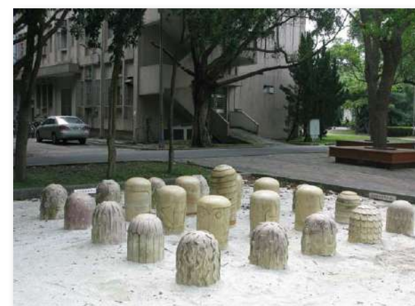
《幻獸》位於獸醫系館南側 作品表材塗料褪色、髒汙嚴重
