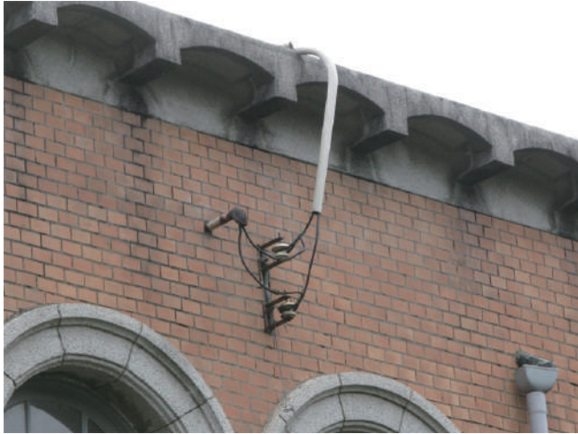
禁止突出及附掛於女兒牆外側立面
