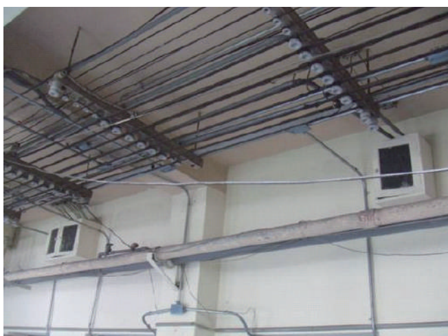
今機械館一樓的舊電線與電箱，迄今仍使用中
