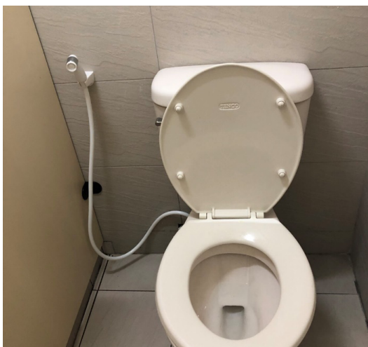
共同教學館沖洗器設置
